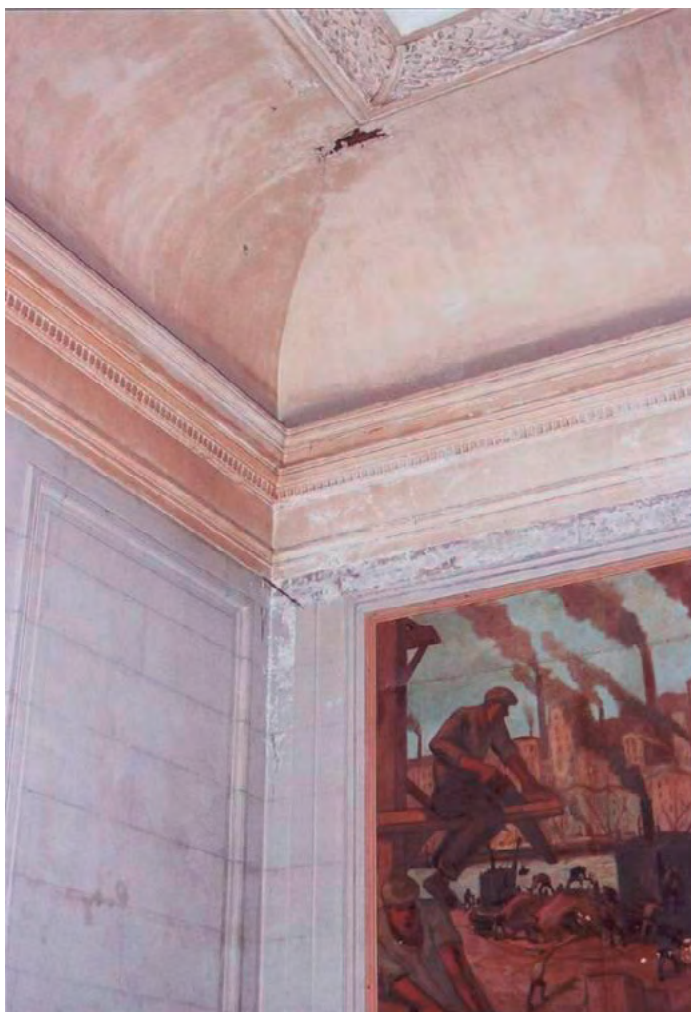
Figura N° 2. Deterioro edilicio producido por filtraciones.
