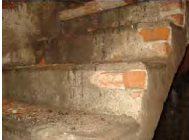
Figura 19: cuarto escalón de la escalera interna.
